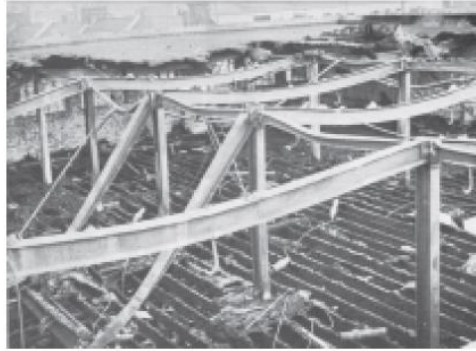
Figura 7.12 Structură portantă din oțel supusă acțiunii focului
